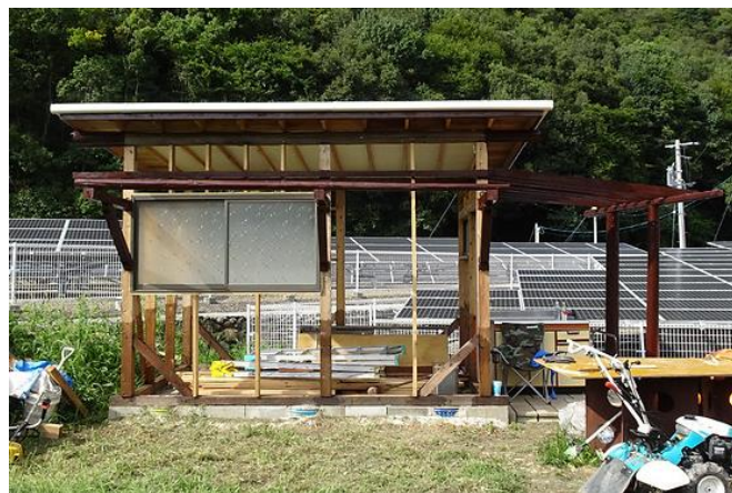
屋根を張る(ポリカ波板使用) サッシや棧木は、ほとんどがもらい物
